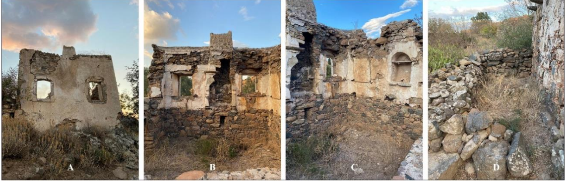
Şekil 11: 679 Ada 4 No'lu Parseldeki Bir Buçuk Katlı Konutun A-Cephe Görüntüsü, B-C- İç Mekân Görünüşü, D- Ayazlık (Kaynak: Ümran Arıcı'nın Kişisel Arşivi)
